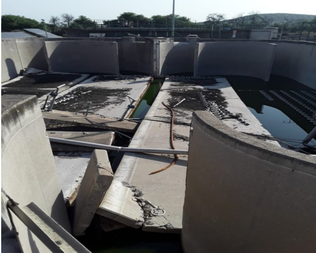
EDAR BUJALANCE - CAÑETE DE LAS TORRES
