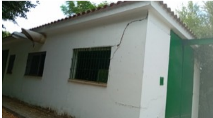
EBAR N° 1 VILLA DEL RÍO
