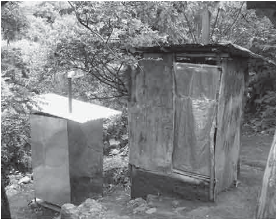
Letrina antigua en mal estado y letrina nueva (La Labranza).
